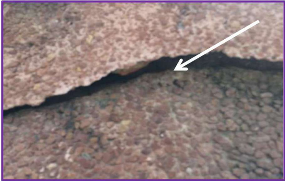
TRINCA DE REBOCO
